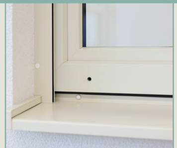
Reguläre Einbausituation: Deutlich sichtbare Gewerkelücke
